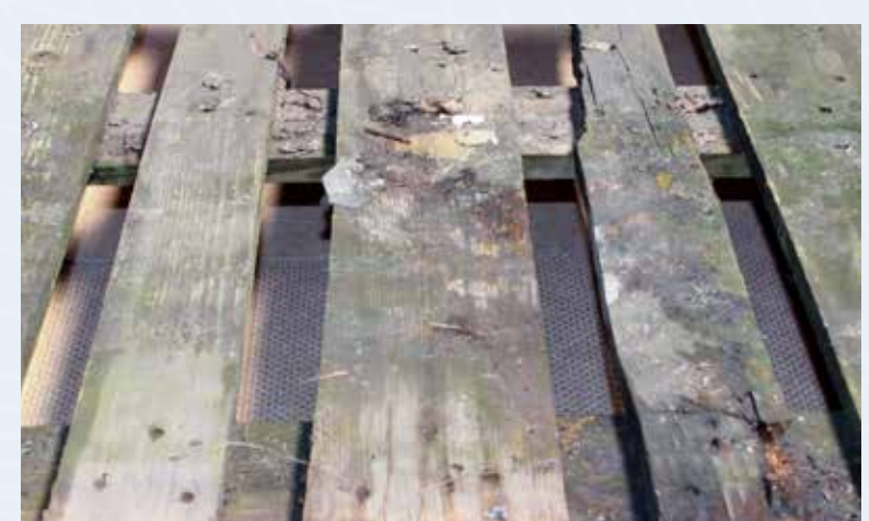
Trocknung/Reinigung durchnässter Bretter
